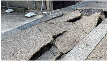
道路損壊(能登町役場周辺)
