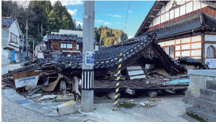
木造寺院倒壊(能登町役場周辺)
